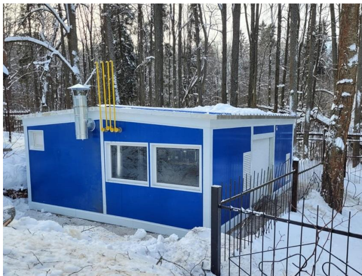
Рисунок 3 - Водогрейная БМК ИНТЕРБЛОК
