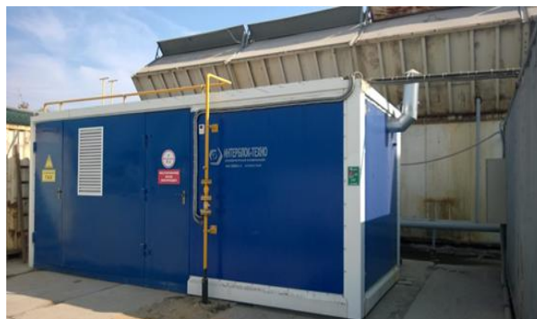
Рисунок 4 - Производственная котельная ИНТЕРБЛОК
