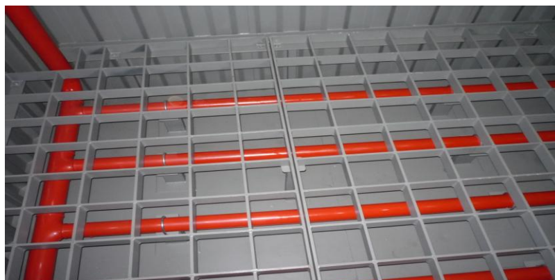
Рисунок 6 - Внутренние греющие паровые трубопроводы
